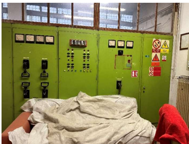
Stávající rozvodna v technickém zázemí ↑
