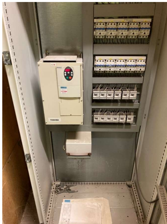
Výzbroj Rozvaděče RM2
