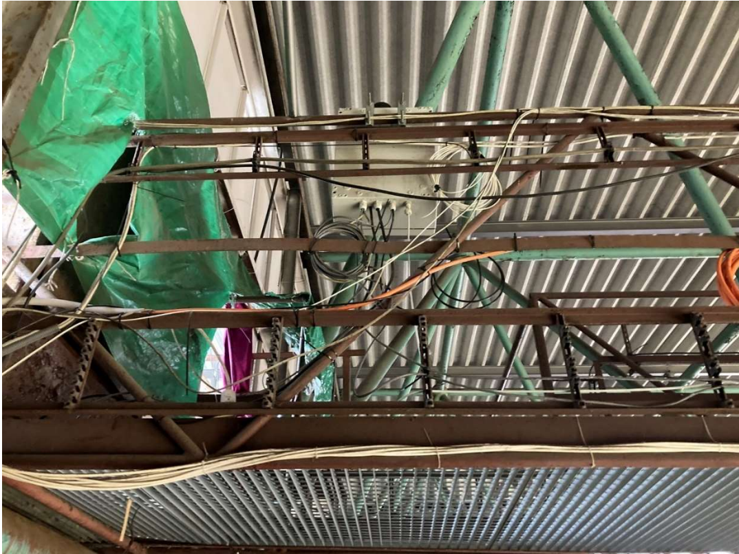
Havarijní stav kabelových tras (smyčky kabeláže, není bezhalogenová kabeláž, uchycení nedostatečné)
