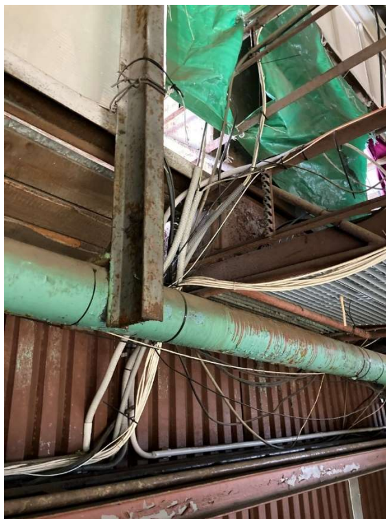
Havarijní stav kabelových tras (nedostatečné uchycení, mechanická ochrana a ochrana před povětrnostními vlivy)
