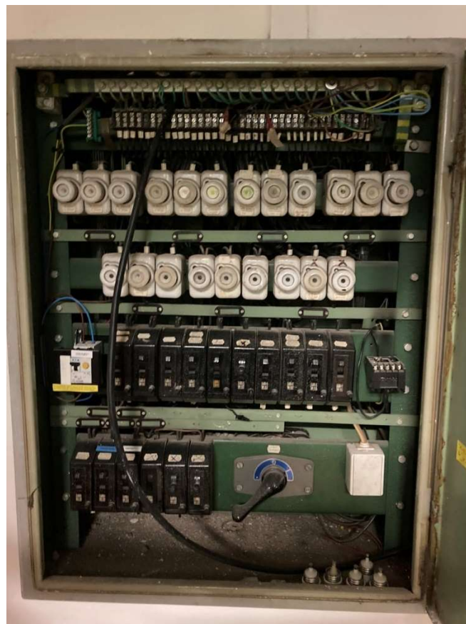
Výzbroj rozvaděče RJ
