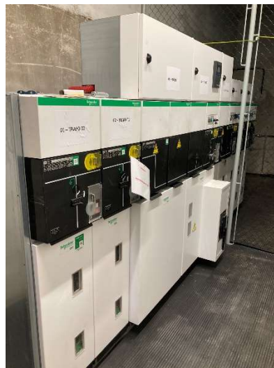
VN rozvodna OC_9566
