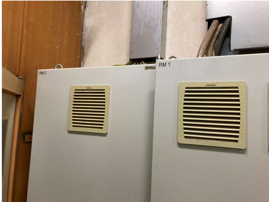
Rozvaděče RM2 a RM1
