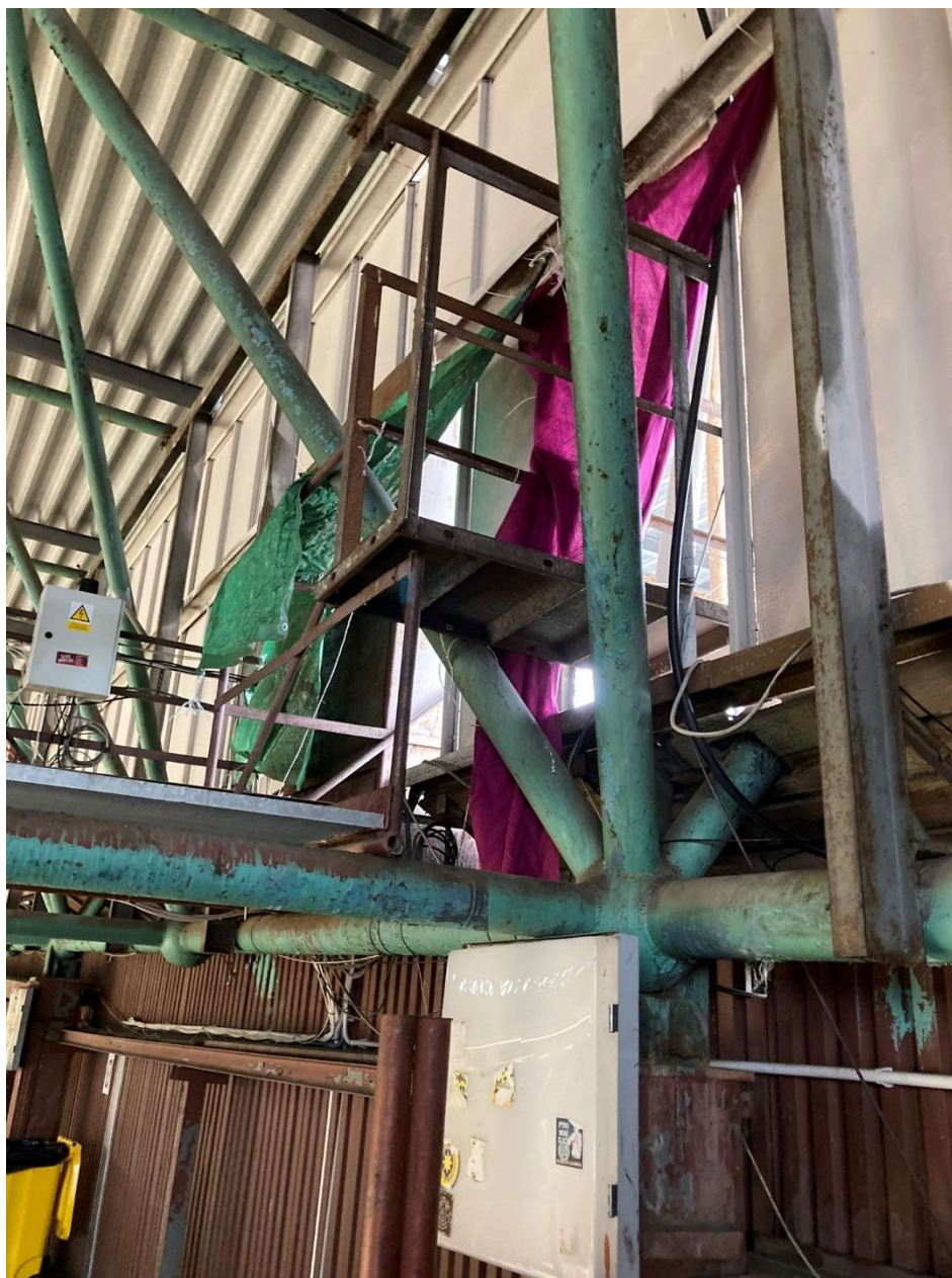
Svítlidlo, servisní lávka, otvor v plášti budovy a vedení elektroinstalace
