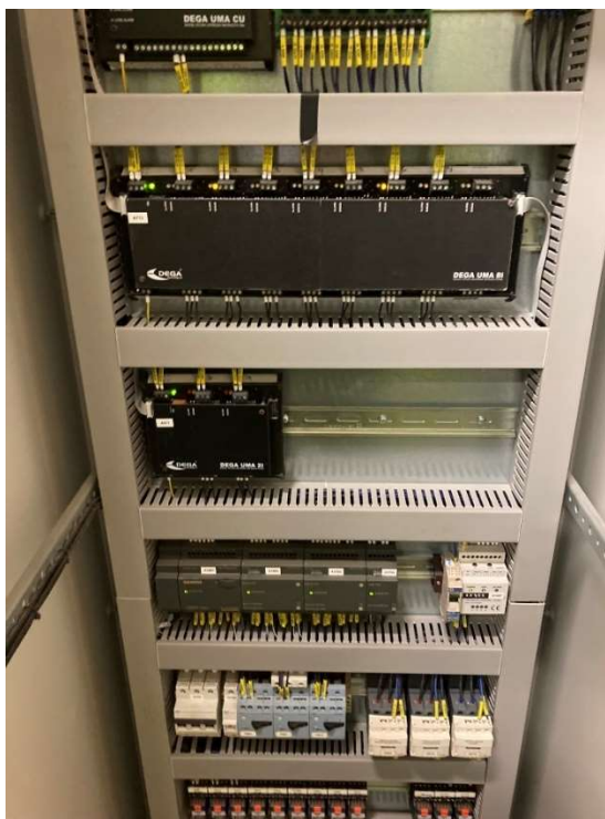
Výzbroj Rozvaděče RHV
